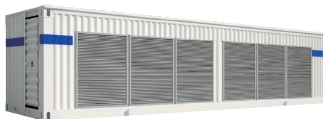
35 кВ, воздушное охлаждение
